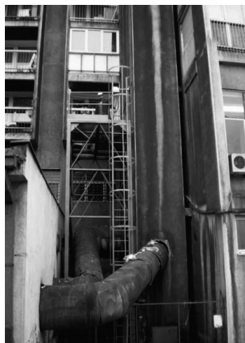
Слика 4.6. Улаз димљача котлова у бетонски емитер
